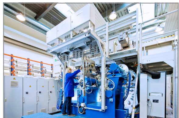
novoflex® 600 Rolle-zu-Rolle Pilotbandbeschichtungsanlage, auf der der neue Prozess zur Abscheidung kolumnarer Siliziumschichten entwickelt wird
